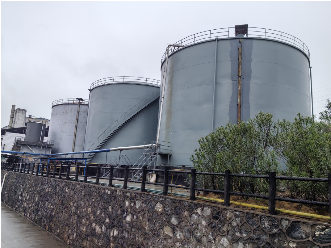
图 1：硫酸罐区照片
